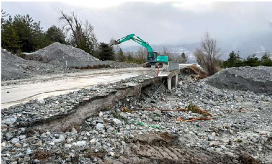
Figure 12 : Dégâts occasionnés au pont le 2 décembre 2023 (Photo CCGQ)
