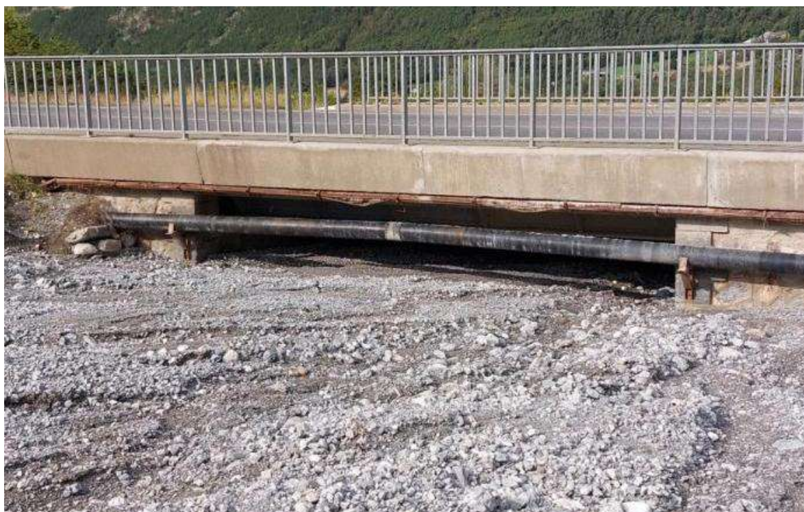
Figure 10 : Niveau d'engravement de la RN94 (Photo HYDRETUDES, Août 2023)
