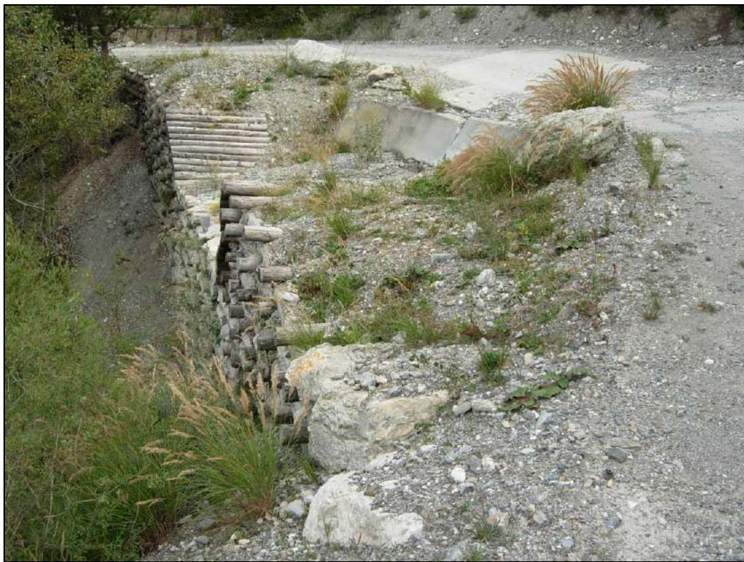
Figure 69 : Seuils en béton et en bois dans le secteur de la Cabane de la Rimas [Source : IMS RN ]
